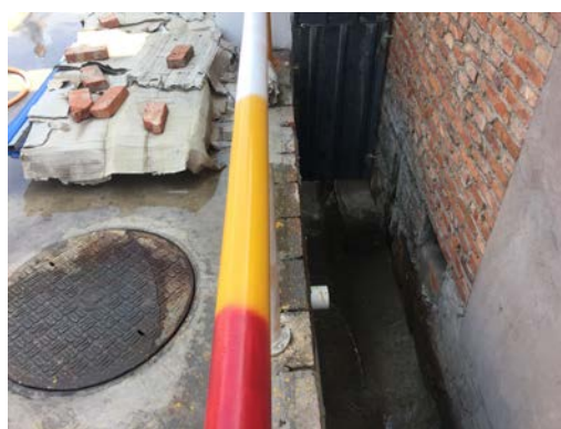
油水分离器排口
