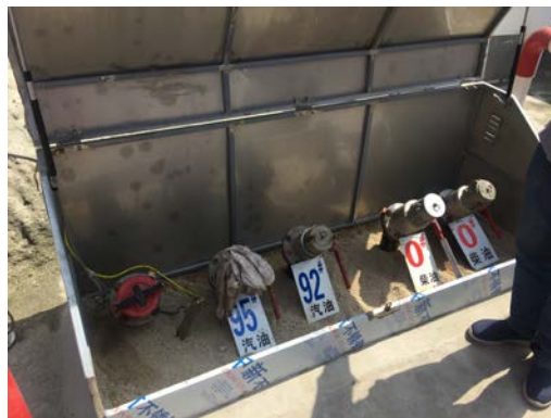
储油罐加油口和油气回收口
