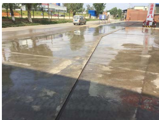
场区雨水收集沟
