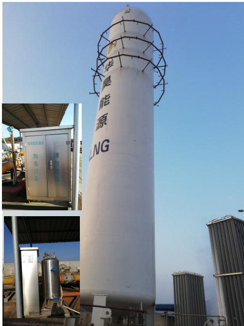
液体储罐及加臭装置
